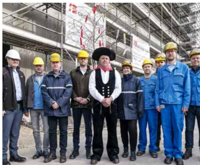
Richtfest für die neue Silicondichtstoffproduktion am Standort Nünchritz. Zur Feier des Projektteams kamen Wolfgang Schattenmann, Leiter der Business Unit Hybrids & Sealants (links) und Werkleiterin Jutta Matreux (fünfte von rechts). (Foto: WACKER)
